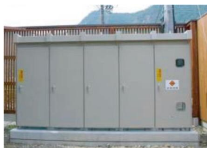
非常用発電機
