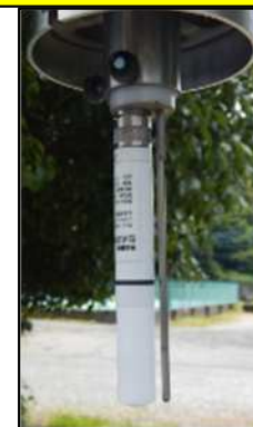
新観測装置 湿度計・温度計センサー
