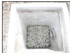
雨水貯留浸透枡整備事例（昭和町）
