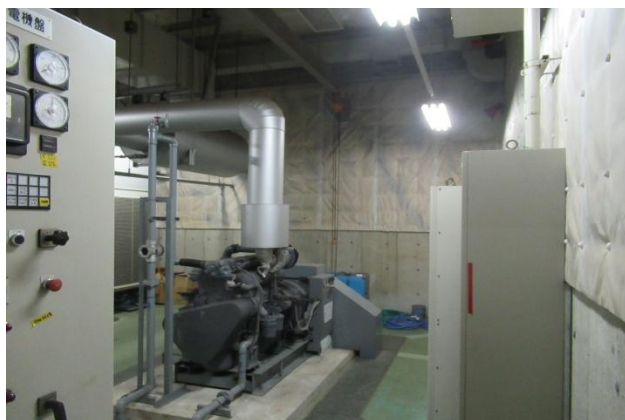
既存自家発電機
