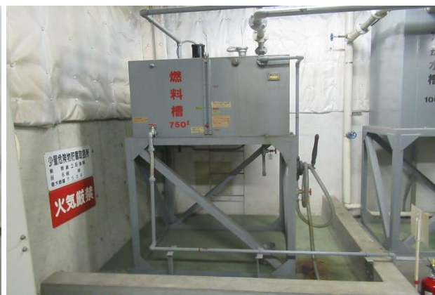
既存燃料小出槽
