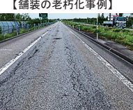
アスファルト路盤の損傷
