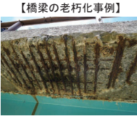
【橋梁の老朽化事例】 床板鉄筋の露出
