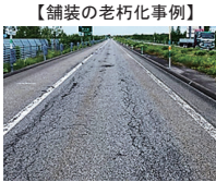
【舗装の老朽化事例】 アスファルト路盤の損傷
