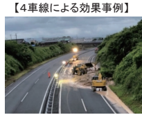
【4車線による効果事例】 被害のない2車線を活用し、 交通機能を確保
