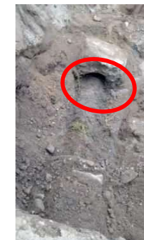
横断水路継ぎ目部に隙間が発生
