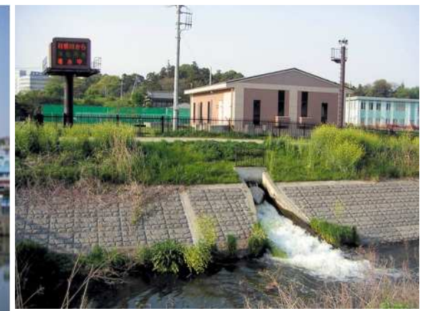
大堀川注水施設(千葉県流山市)
