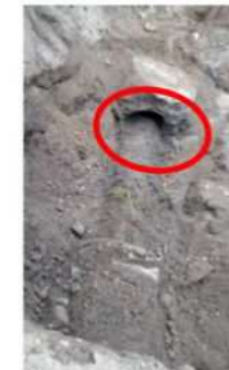
横断水路継ぎ目部に隙間が発生
