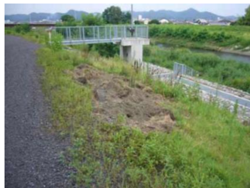
写真 4-2 イノシシによる堤防損傷状況
