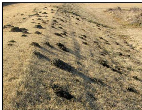
写真 3-10 モグラ穴による被害状況
