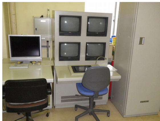
写真 6-24 三杉排水機場 操作卓
