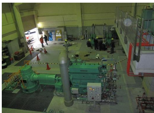
写真 6-30 菊沢川排水機場（ポンプ設備）
