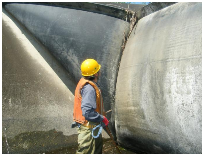
写真 6-28 ゴム引布製起伏ゲート設備の点検
