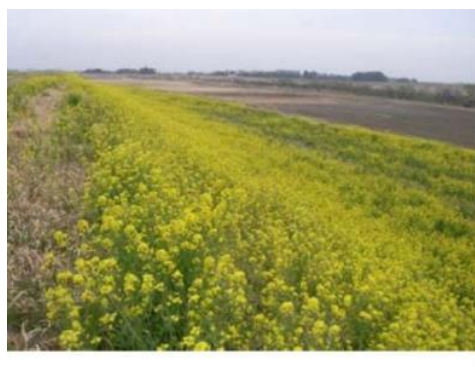
写真 3-9 堤防法面のセイヨウカラシナの繁茂状況
