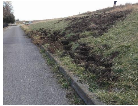
写真 6-7 イノシシによる堤防掘り起こし
