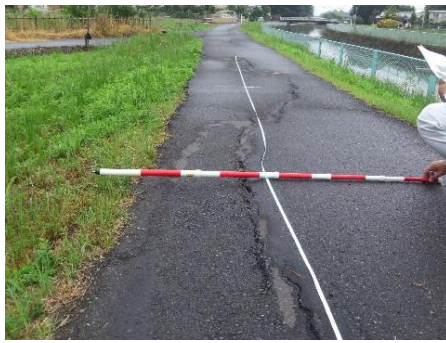
写真 6-6 堤防天端の亀裂
