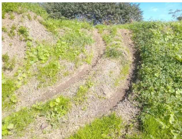
写真 6-37 車両による堤防への損傷
