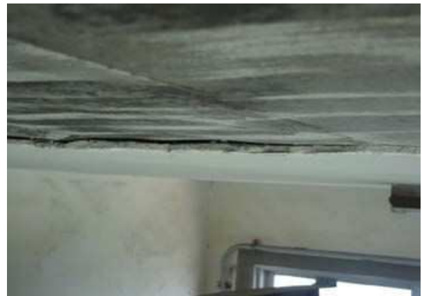
写真-3 操作室天井モルタル剥離
