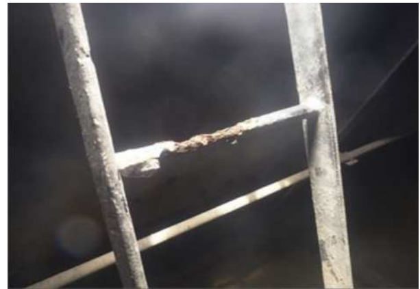
写真-2 昇降設備腐食
