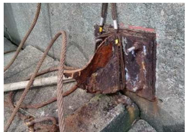
写真-4 予備ゲート固定金具腐食
