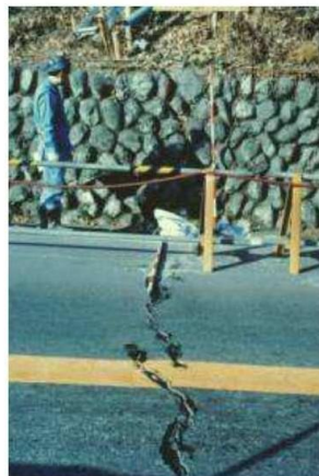
国道462号に発生した亀裂
