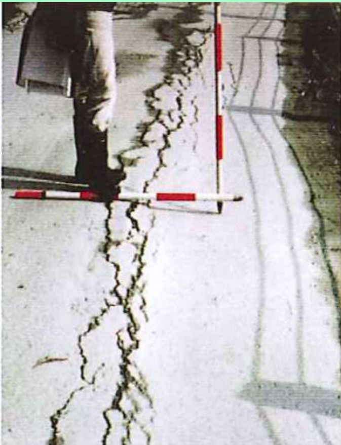
地すべりを横断する農道に見られる亀裂
