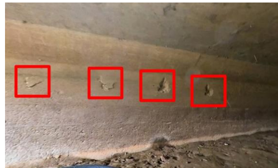
写真-7 損傷状況
