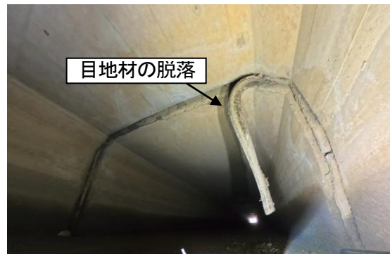
写真-8 目地材の脱落状況
