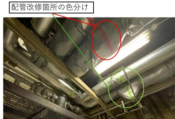
図-8 配管施工の色分け
