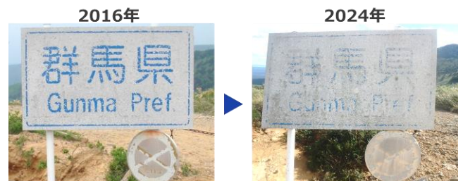
図-2 標識劣化状況
