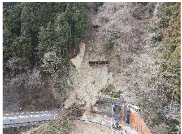
写真-2 被災直後の現場状況（2025年3月撮影）
