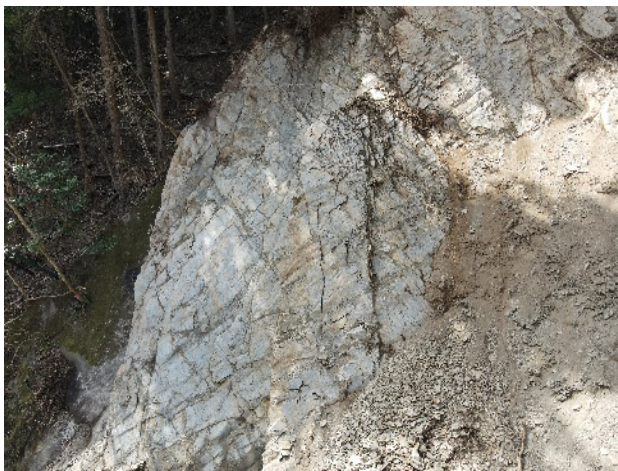
写真4 崩落面の状況
