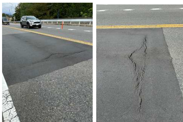
写真-6 応急措置箇所の舗装のずれ
