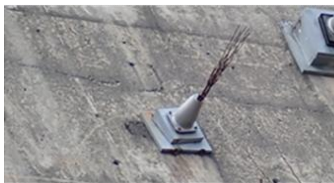
写真-1 アンカーの飛び出しの事例
