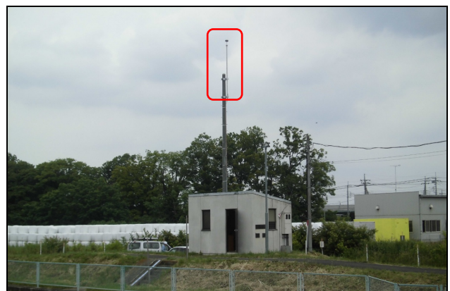
写真-2 羽刈堰に設置されている避雷針
