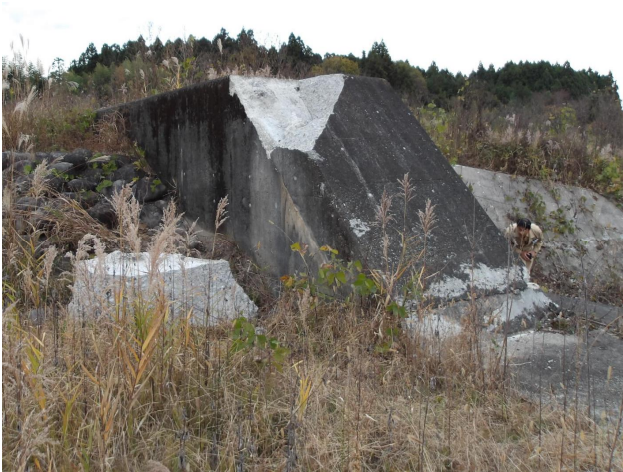
写真1 左岸側袖部損傷状況
