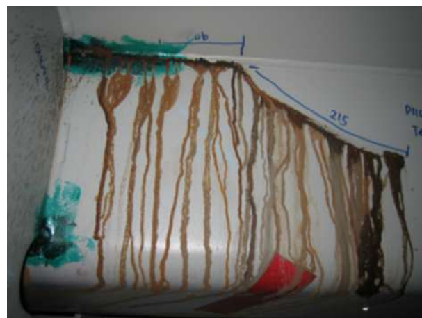
2- (2) U リブの疲労亀裂と漏水の状況
