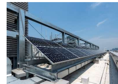
【太陽光発電設備】
