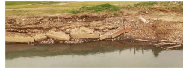
被災状況(利根川左岸 群馬県太田市徳川町地先)
