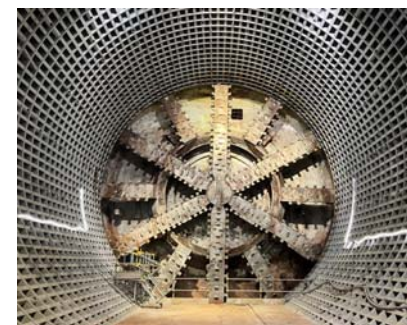
写真⑤：マシン前面の状況 (バックアンカー・鋼製隔壁・流動化処理土撤去後)
