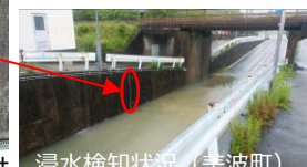
浸水検知状況（美波町）
