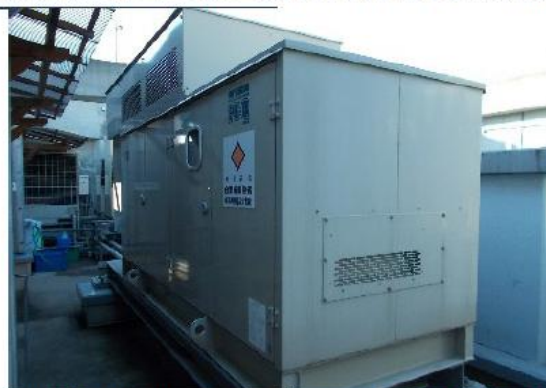
病院敷地内に設置された自家発電設備
