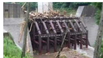
例:透過型砂防堰堤による流木の捕捉
