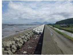
消波ブロック整備状況
