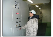
(ポンプの運転)
