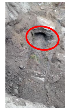
横断水路継ぎ目部に隙間が発生
