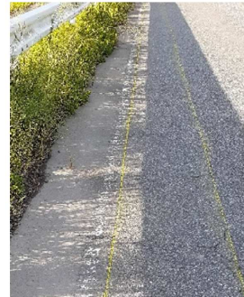
区画線の摩耗
