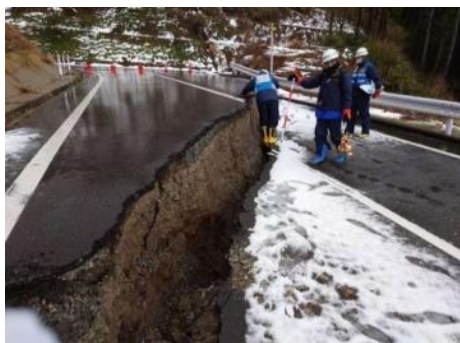
被害状況(道路)の調査 (石川県志賀町)
