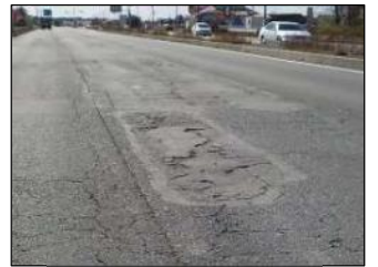
舗装の剥離・ひび割れ
