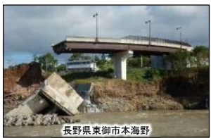
長野県東御市本海野 河川沿いの橋台崩落
