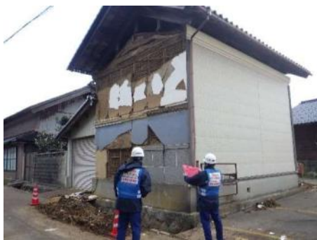
建築物応急危険度判定 (石川県志賀町)
