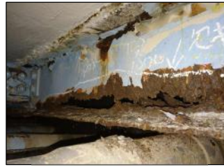
漏水による橋桁の腐食
