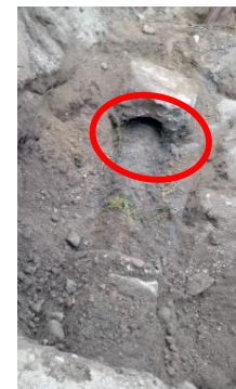
横断水路継ぎ目部に隙間が発生
