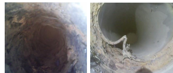
プール給水口の劣化状況
