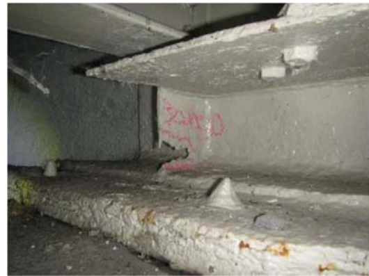
・主桁の腐食 <縦桁補修>
