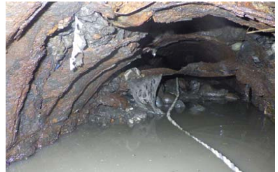
<埼玉県草加市内:コルゲート管内損傷状況>
