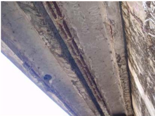
・主桁の剥離・鉄筋露出 <主桁補修>
