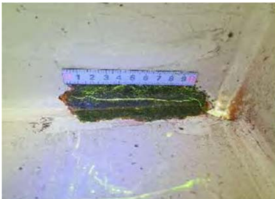
【要補修損傷箇所】
