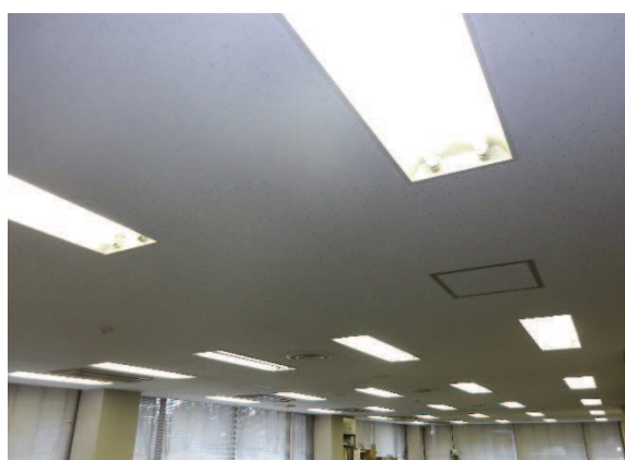
本館 照明器具
