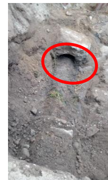
横断水路継ぎ目部に隙間が発生
