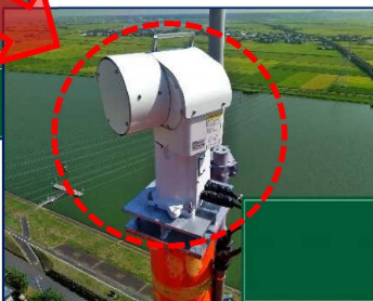
▲更新後のCCTVカメラ
