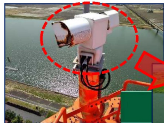
▲老朽化したCCTVカメラ
