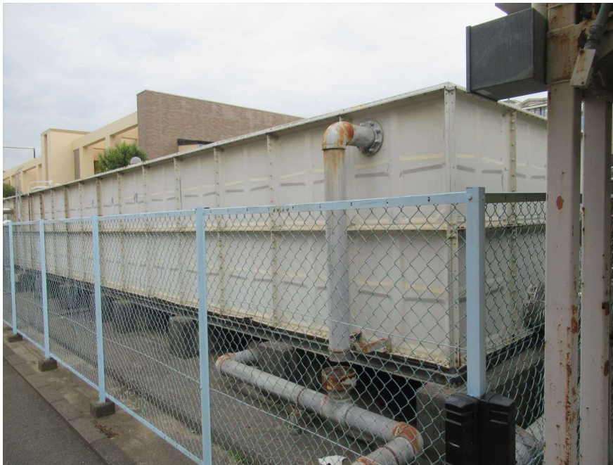
既存ポンプ室付受水タンク
