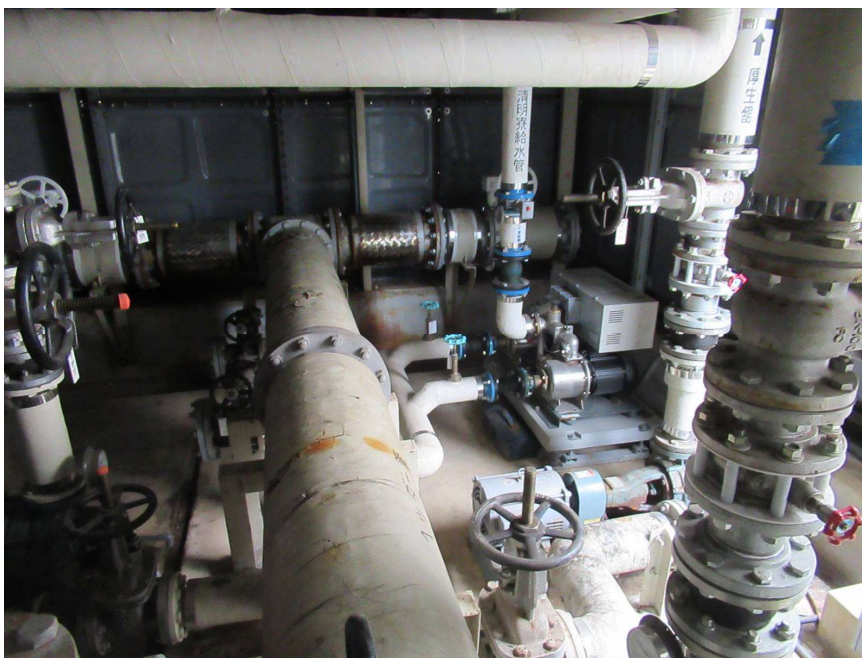
同 ポンプ室内
