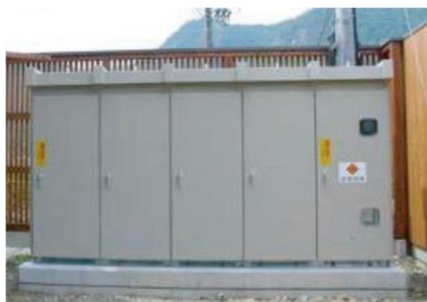
非常用発電機
