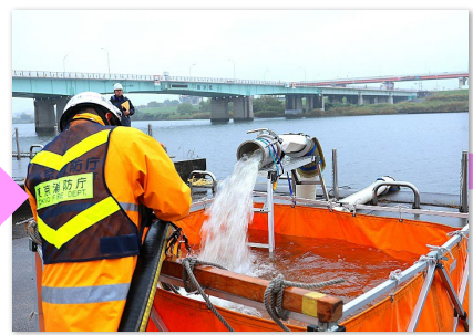
荒川からの河川水を取水し、中継水槽へ貯水を開始
