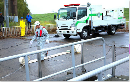
東京都建設局の排水ポンプ車が配置
