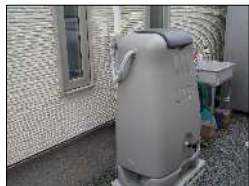
貯留槽の整備事例(富士市)
