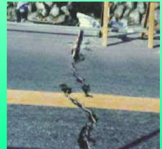
国道462号に発生した亀裂
