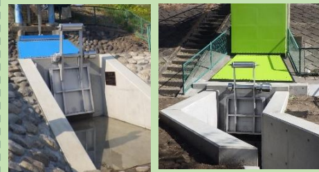
既存施設を改良して、無動力化を実施した例
