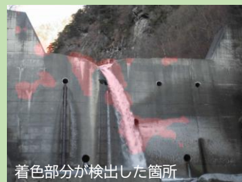
AIによる砂防堰堤変状箇所の自動検出例
