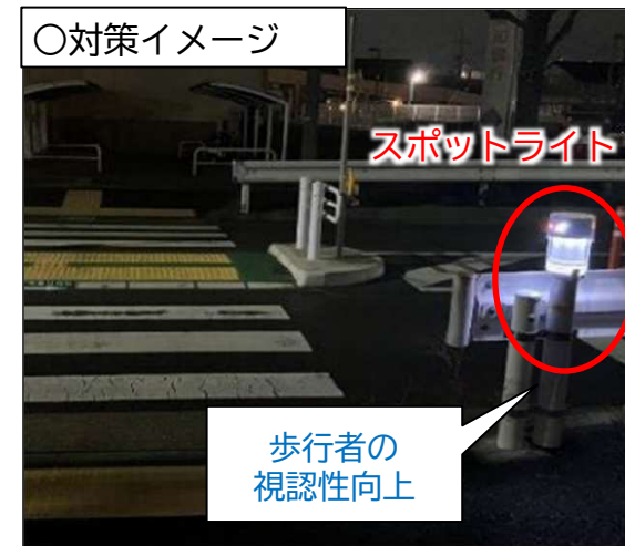
センサー付きスポットライト (既設横断歩道)
