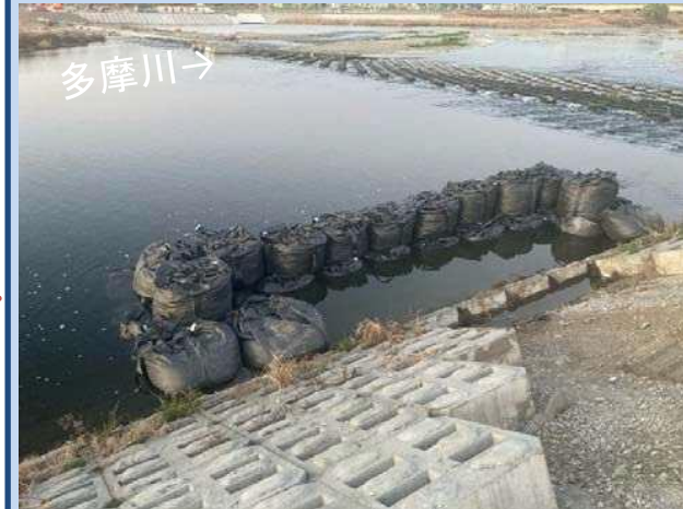
水路を設置するため仮締切を設置しています。 (令和7年12月)
