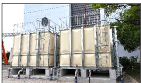
▲水道水受水槽
