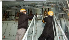
▲発電機の点検状況（三郷排水機場）
