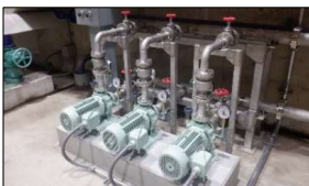
▲受水槽からの水を軸封部へ圧送する軸封水送水ポンプ
