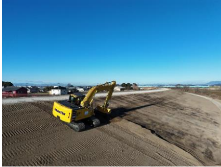
澄みきった青空の下での法面整形 撮影：河本工業（株） 村田 僚
