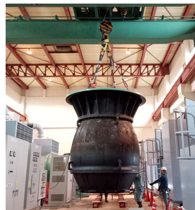
設備の整備状況
