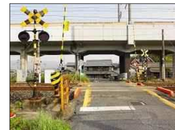
遮断機・警報機の整備
